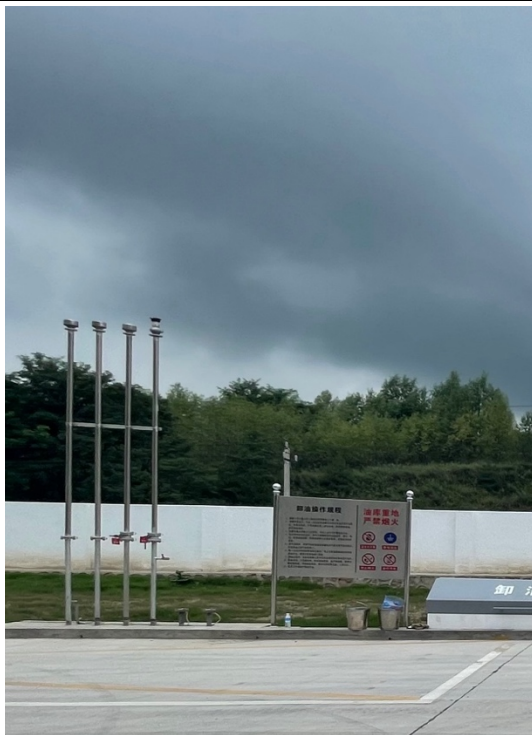
储罐油气回收装置
